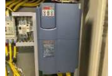
空調機変风量制御 (INVユニット)
