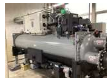
ターボ冷凍機 冷房能力：879.1kW
