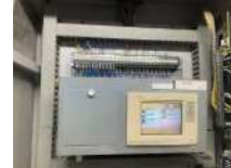
ポンプ推定末端圧制御 (コントローラ)
